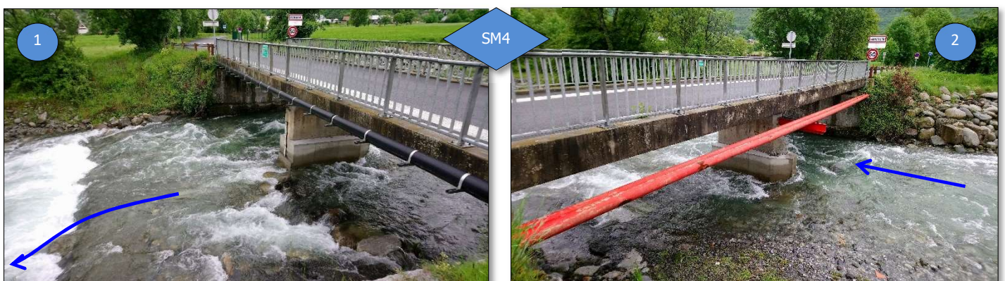
Figure 10 : Pont interzones (1) → Vue amont, note la conduite réduisant la section et favorisant l'embâchage, (2) → Vue aval, le seuil parafouille et ses coursiers sont visibles. La section se trouve rétréci notablement (- 52 % en 90 m) par la présence du pont qui a un appui en lit
